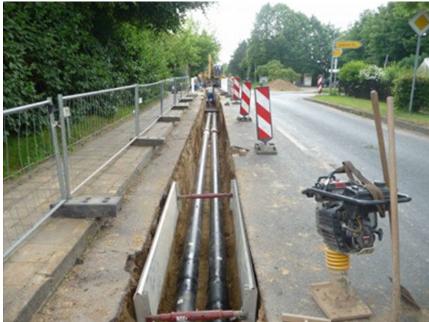
Wärmeleitungen, Vor- und Rücklauf
